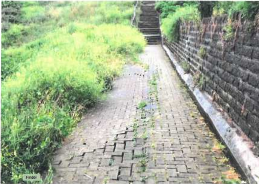
Acceso a las escaleras de la subida la Atalaya. Pasillo roto (3.1)
