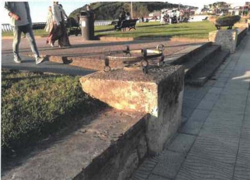
Jardinera desaparecida en el paseo marítimo (2.2.2)
