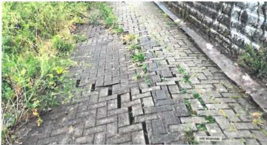
Acceso a las escaleras de la subida la Atalaya Pasillo roto (detalle) (3.2)
